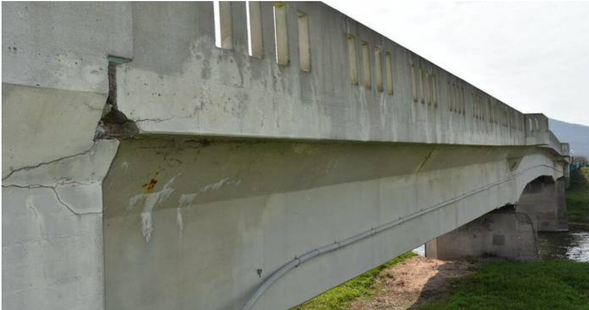
Schlechter Zustand der Werrabrücke bei Aue. Foto: Jessica Sippel
