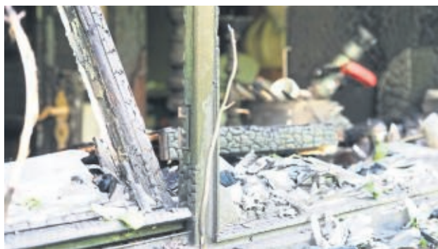
Ein Bild der Zerstörung: Das Feuer griff von der Küche aus auf den Dachstuhl über.
